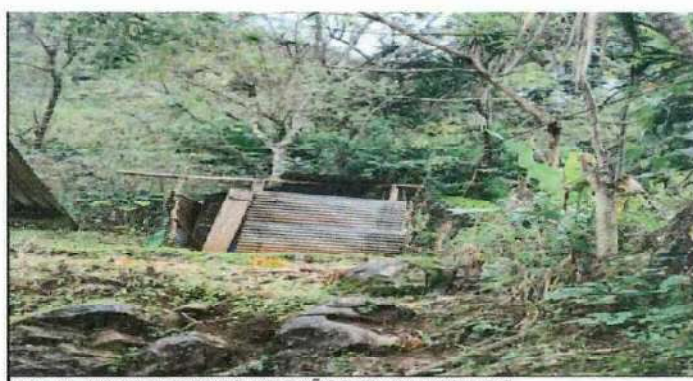
Foto 6: MANTENIMIENTO DE BAÑOS EN MAL ESTADO
